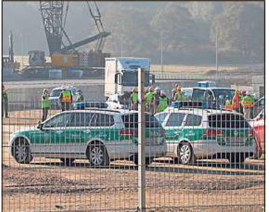
Auf der Amazon-Baustelle im Gewerbepark Aurea fahndeten Zollbeamte am Mittwoch nach möglichen Schwarzarbeitern. Bild: Reckeweg
