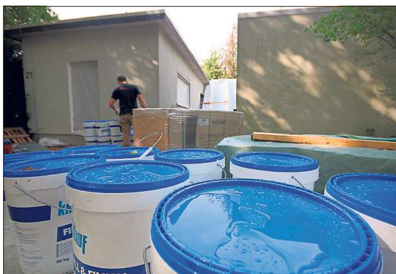
Am Burgweg 21 wird derzeit die alte Hausmeisterwohnung in einen zweiten Standort des Burgkindergartens ausgebaut.
