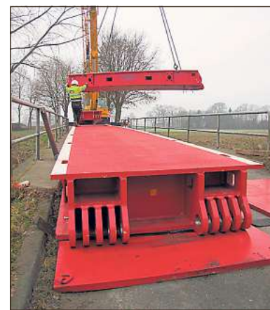
Rotes Schwergewicht: das Brückenüberfahrssystem.
