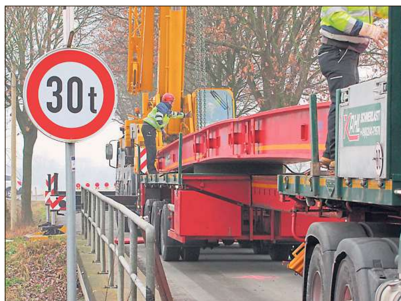
Rückwärts auf die Brücke wurden die tonnenschweren Teile gefahren und dann vom Auflieger gehoben.
