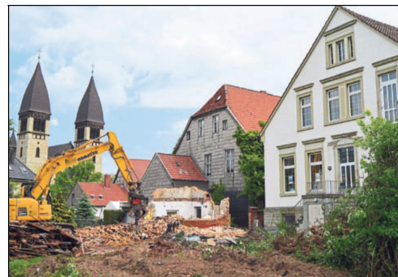
Am Schnitkerhaus wird gebaut, die ersten Gebäudeteile sind schon beseitigt worden. Foto: Jan Gruhn
